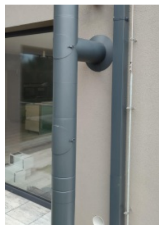
Lakovaný komín s kulatým čistícím otvorem
