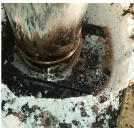
Následek chybně zaizolovaného prostupu komínu stropem
