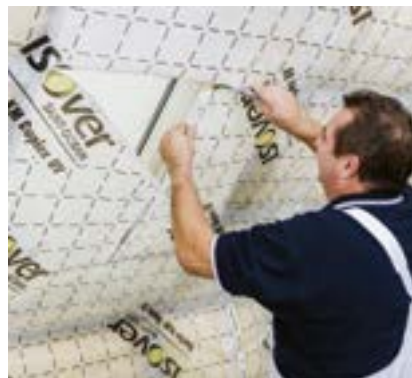
Aplikace parozábrany (v oblasti střešního okna parozábrana proříznuta ve tvaru písmene „I“)
