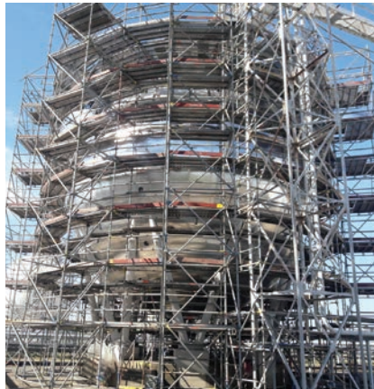
Izolace kulového zásobníku
