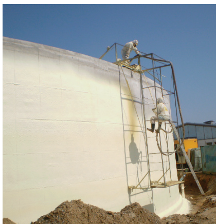
Tepelná izolace vnějšího pláště fermentoru
