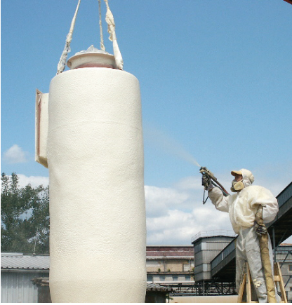
Bezspárá izolace na plášti ocelového nádrže
