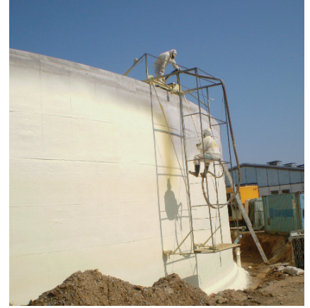
Tepelná izolace vnějšího pláště fermentoru
