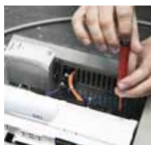
Integrovaný systém MaR kompletní elektroinstalace systému přímo ve výrobním závodě
