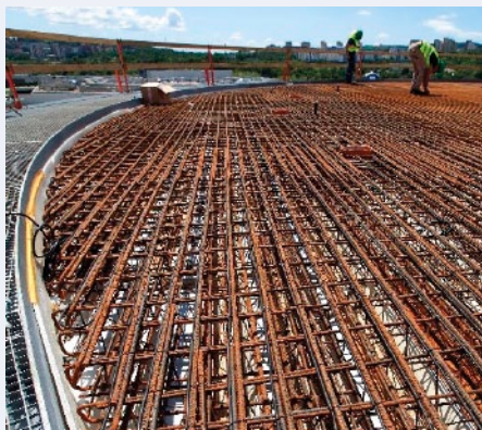
Heliport, nemocnice Bory, Bratislava, Slovensko
