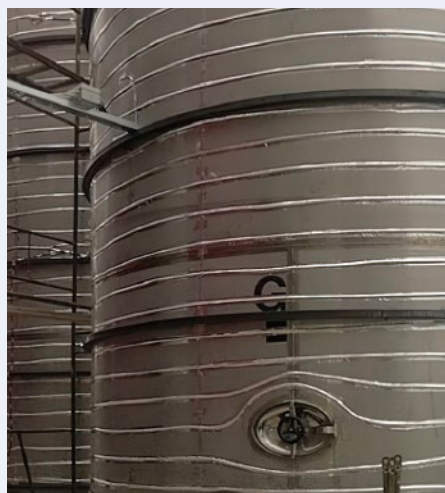
Technologický ohřev kapaliny, Rumunsko
